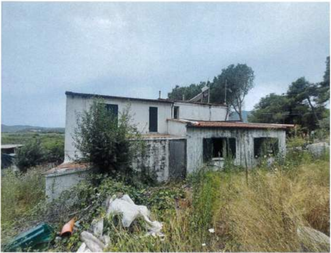
Descrizione: vista prospetto retro, presenza di superfetazioni realizzate nel corso degli anni.
