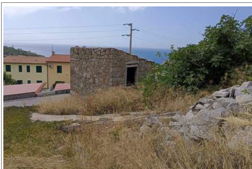
Descrizione: punto di ripresa lato Nord; mostra l'assenza di aggetti di gronda ed elementi di pregio da salvaguardare
